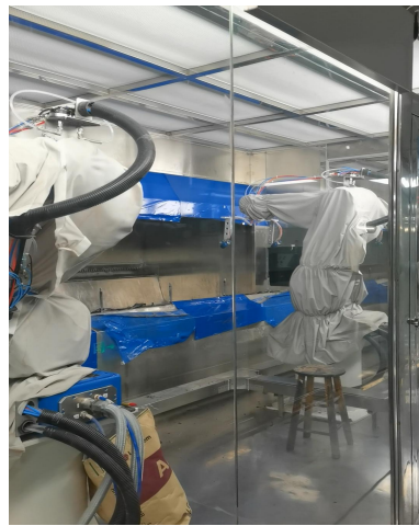
喷漆车间面漆喷漆房 4#
