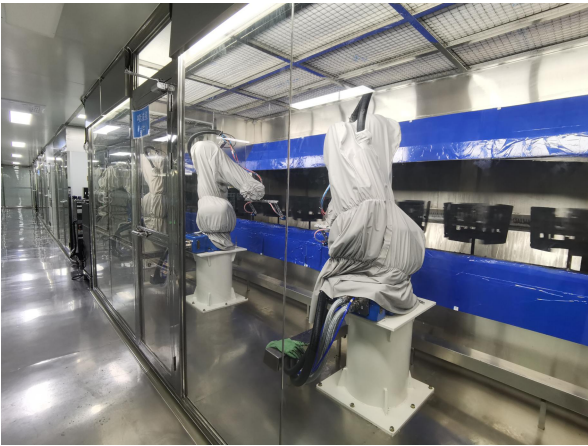
喷漆车间底漆喷漆房 3#
