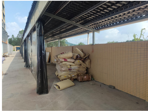
一般固废暂存点
