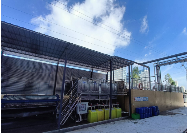
废水净化治理回用系统
