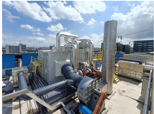
有机废气深度治理系统
