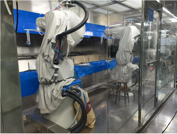
喷漆车间底漆喷漆房 1#
