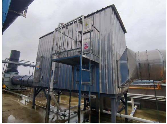
注塑废气净化治理系统
