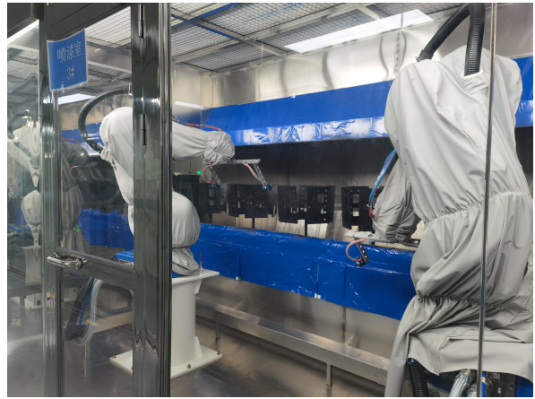
喷漆车间面漆喷漆房 2#
